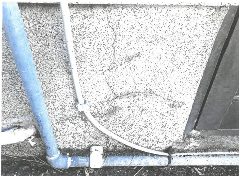
基礎部分の亀裂
