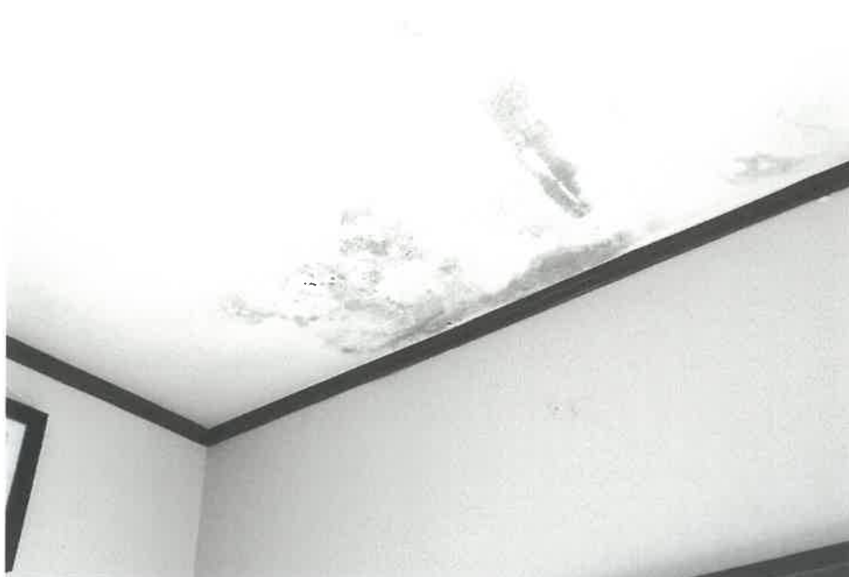
天井の雨漏り跡
