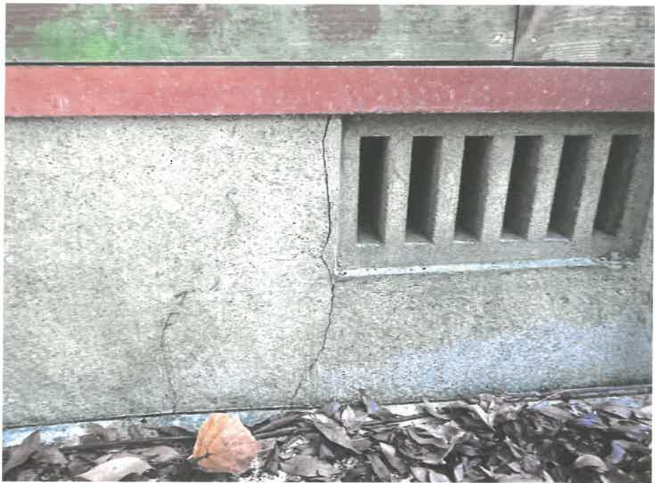
基礎の亀裂箇所
