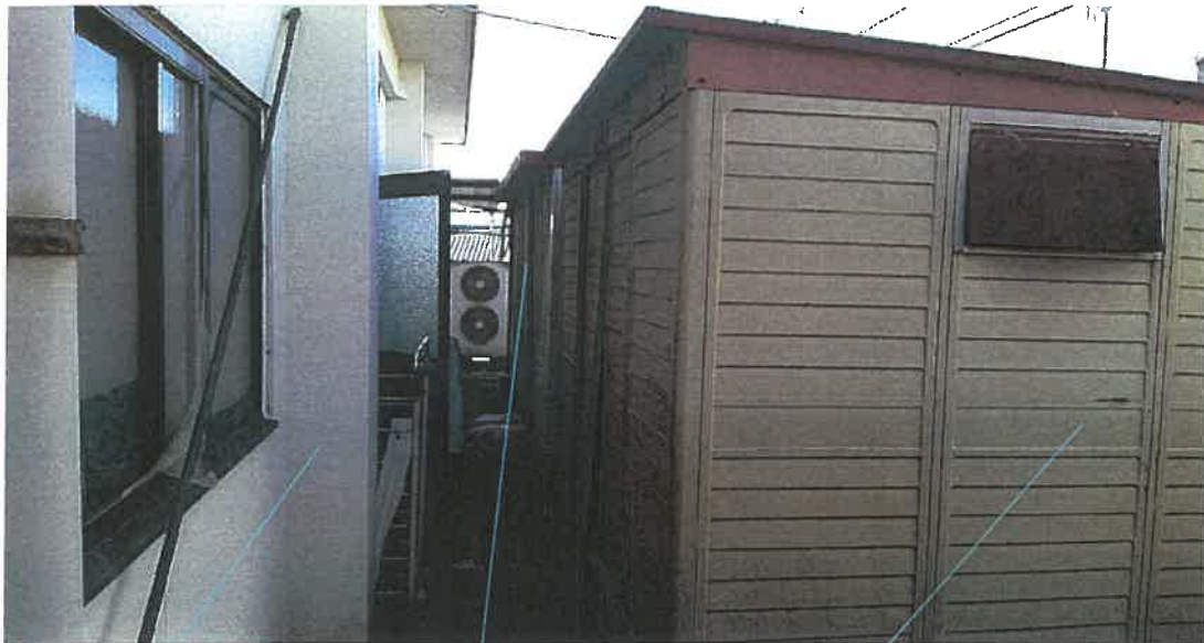
物件 2 2 階ベランダ状況
