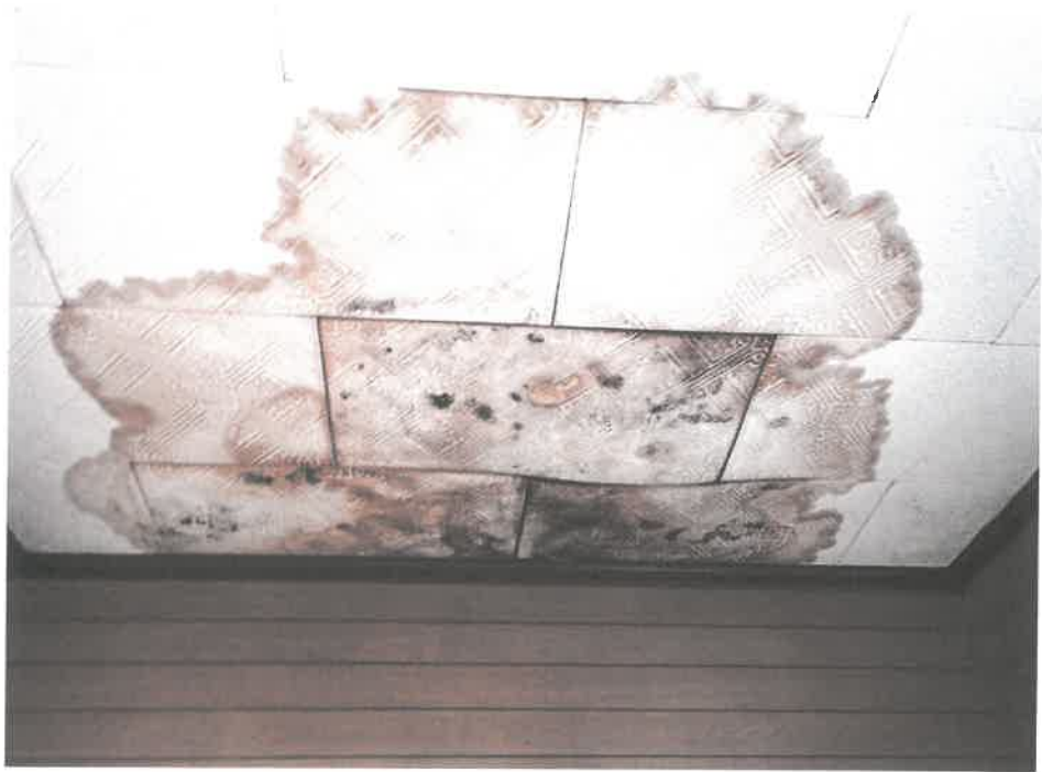
雨漏りの状況
