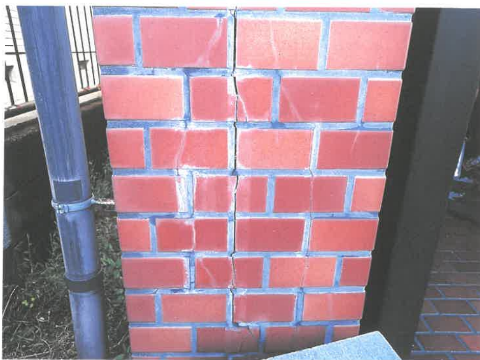
外壁の亀裂箇所
