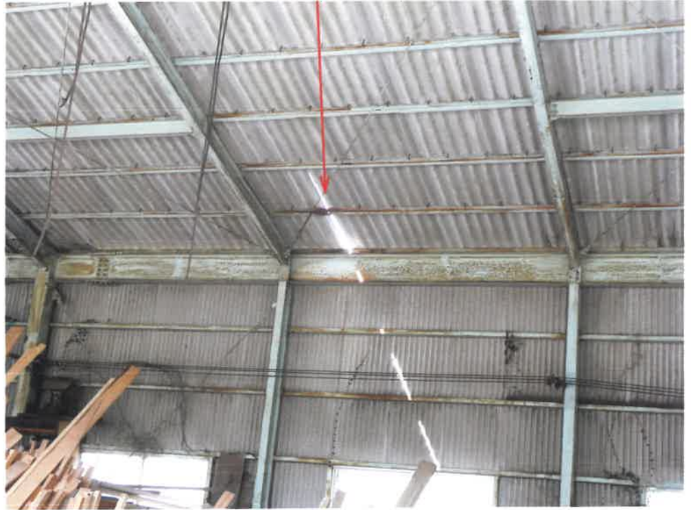
天井の破損部分
