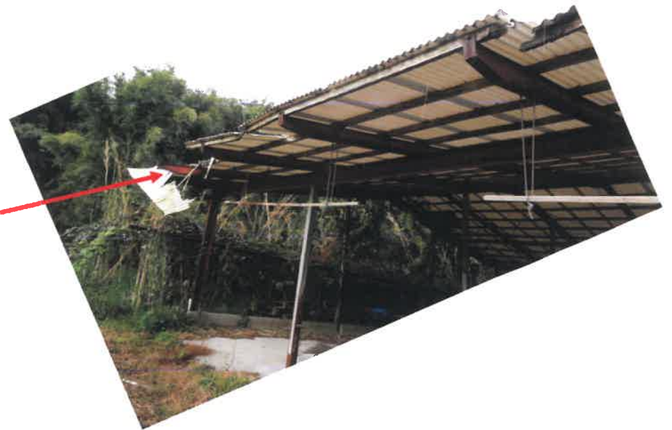
下屋の破損状況
