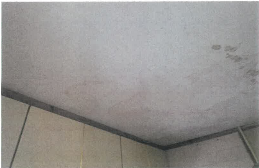
同上(雨漏り痕の存在)
