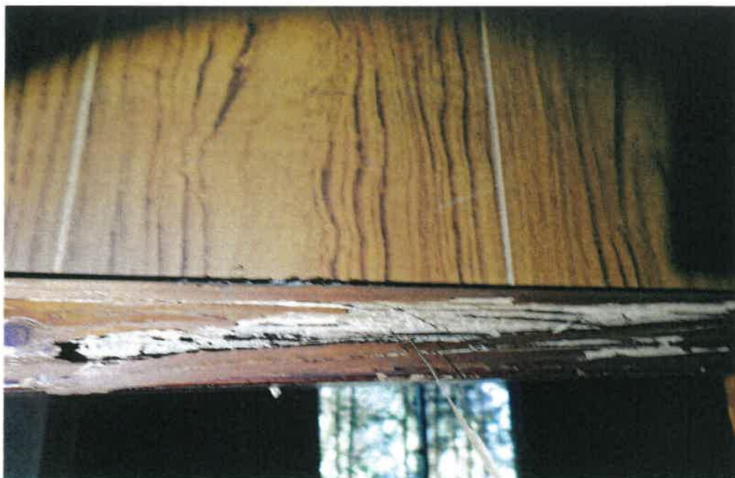
本件建物内部(シロアリによる侵食の状況)
