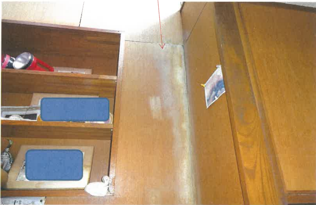
物件2の室内(1階の雨漏り箇所)
