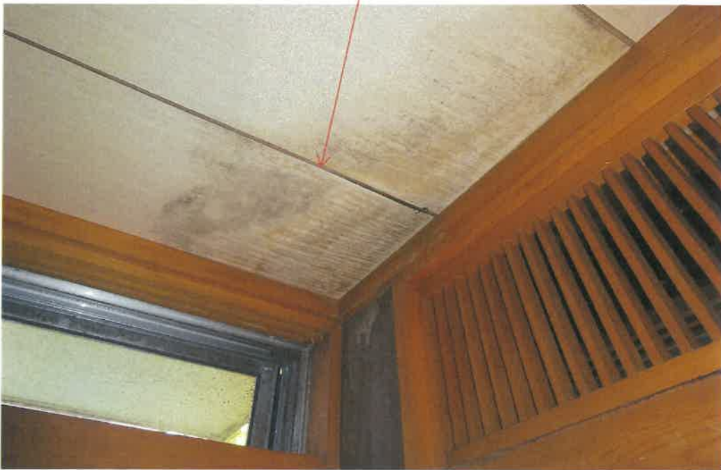
物件2の室内(1階の雨漏り箇所)
