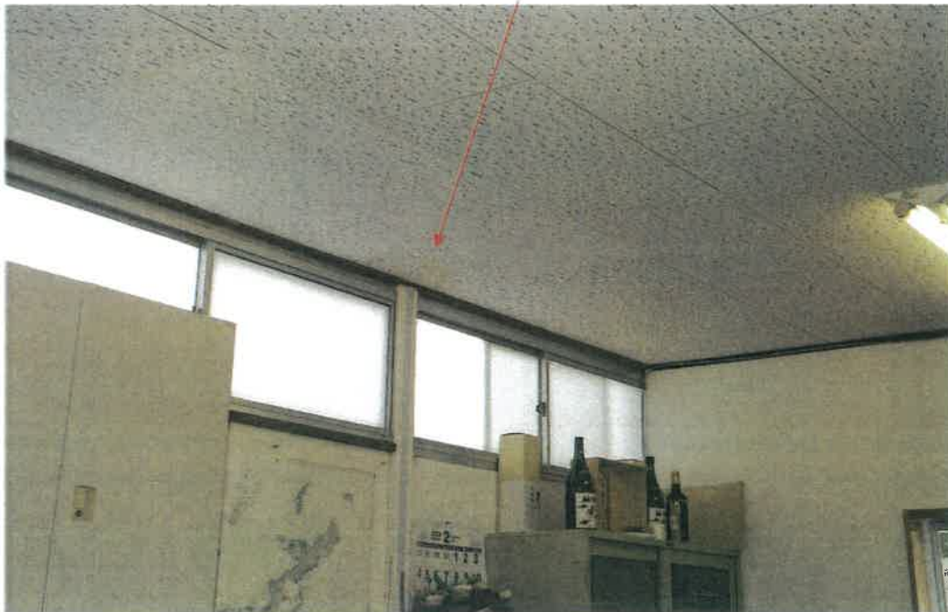
同上(室内:雨漏り箇所)
