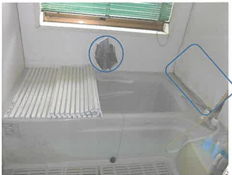
写真 6 浴室(内壁の損傷状況)
