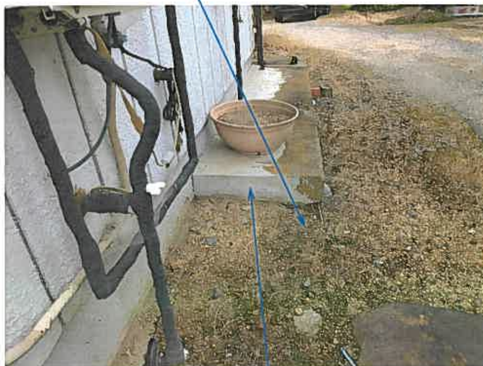
地番 1 3 番 4 に越境して設置されている犬走り
