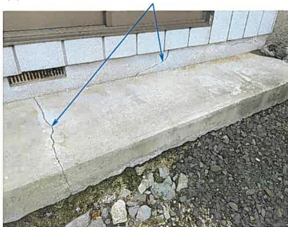
物件2の基礎部分等の亀裂
