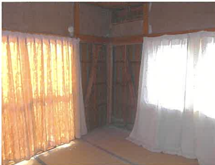
写真 1 1 内壁の一部が剥離したままになっている状況
