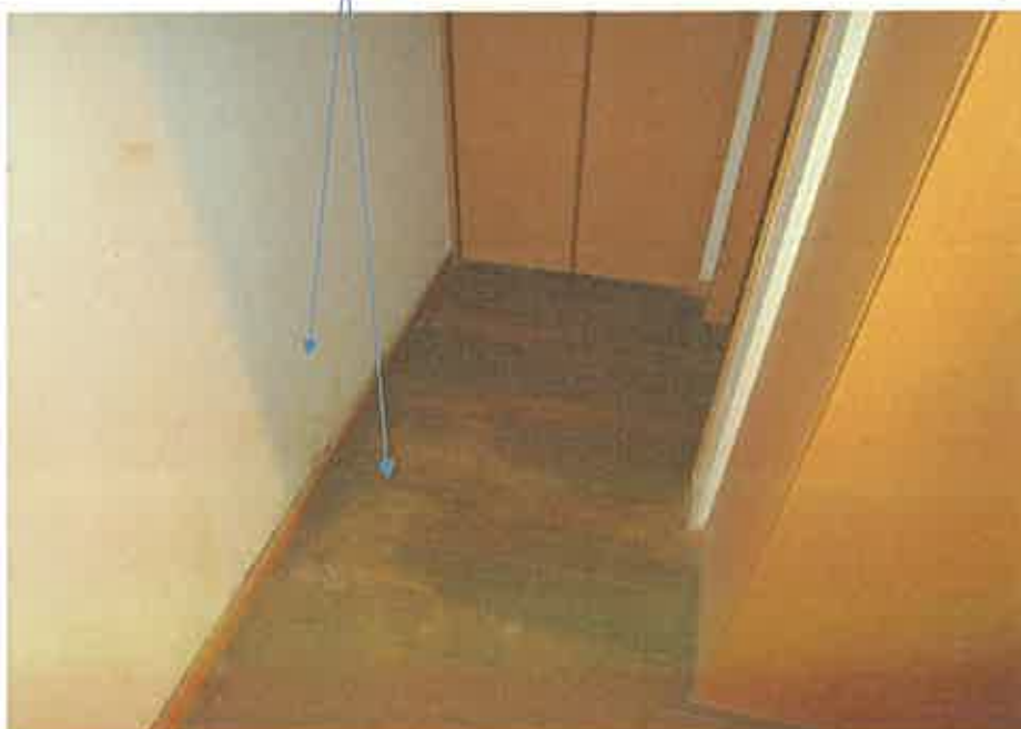
写真⑥ 床や壁の汚れ
