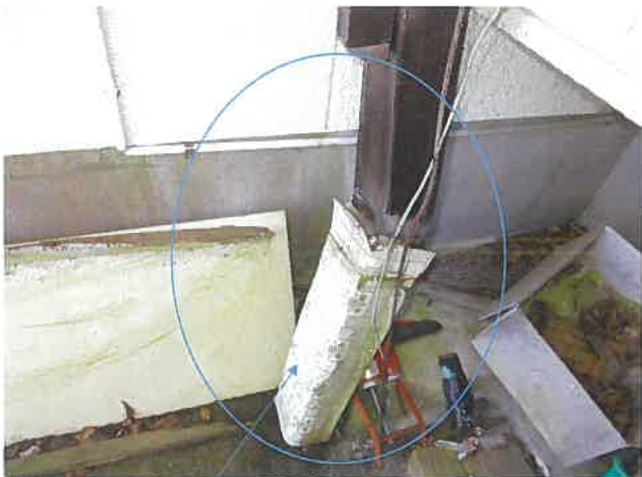
カーポートの支柱の歪み
