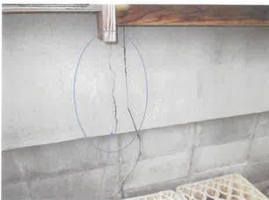
物件2: 台所側外壁のひび
