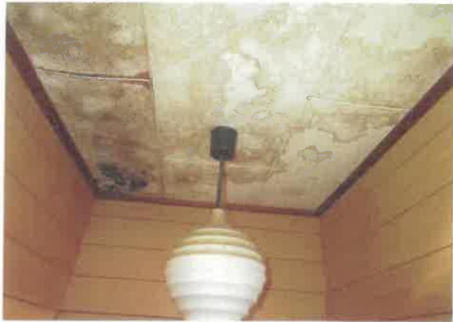
物件2:2階階段の天井のしみ等の状況
