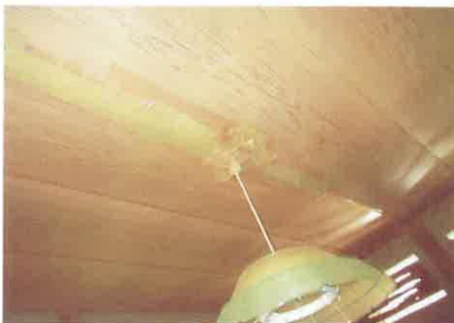
物件2:2階北西側和室の天井の破損状況
