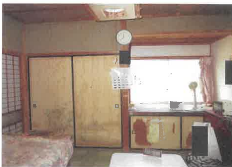
物件2:1階南側和室の状況
