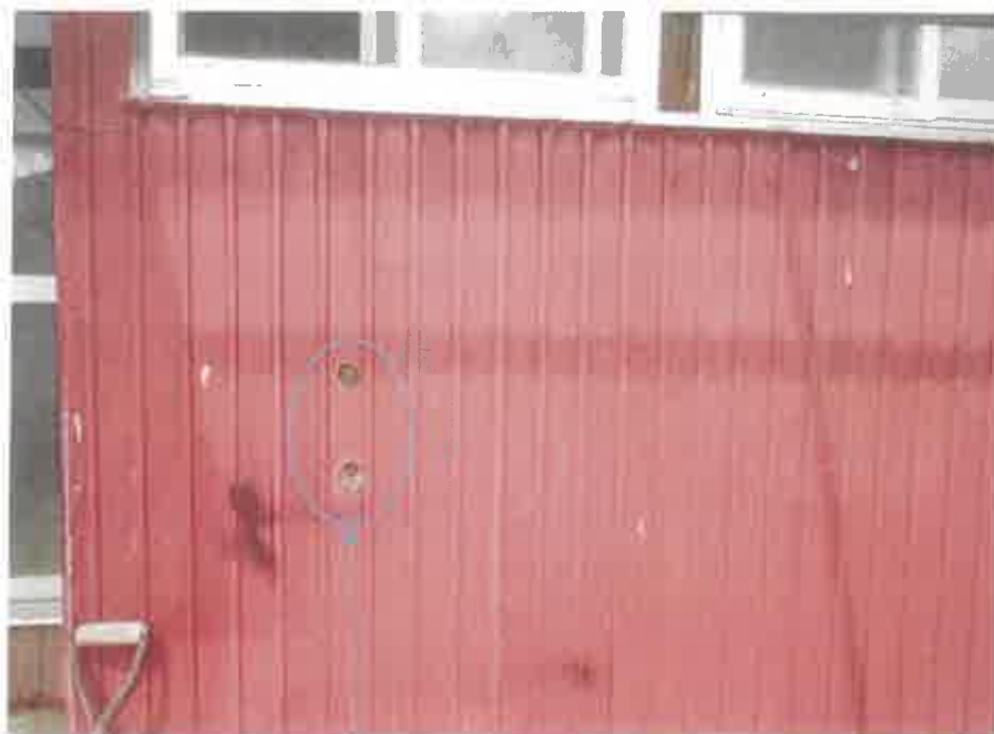
物件2:1階トイレ側外壁の穴
