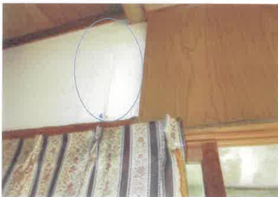
物件2:1階廊下の内壁のひび
