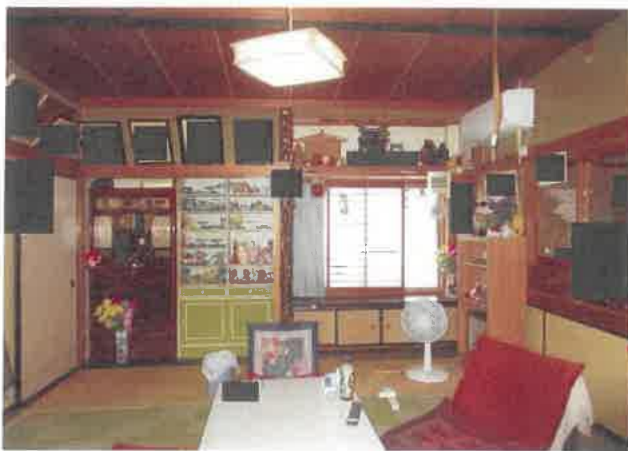
物件2:1階北側和室の状況
