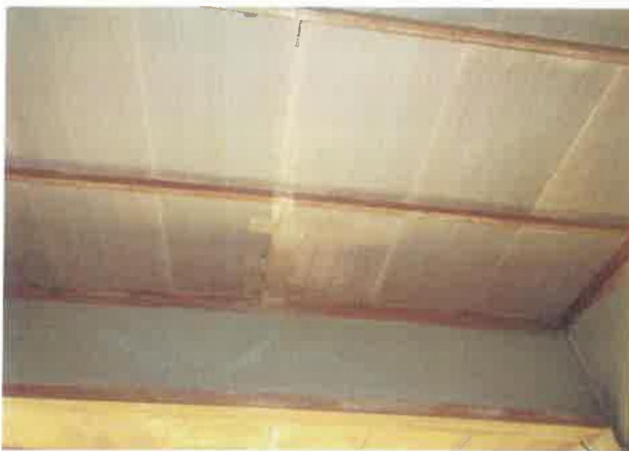
物件2:1階南側和室の天井の剥がれ等の状況
