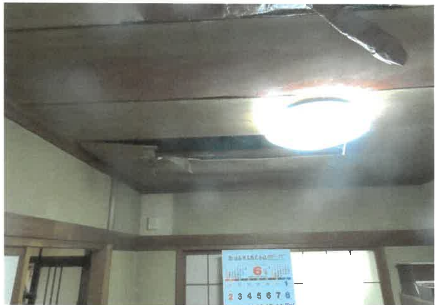
物件2:3階和室の天井の状況
