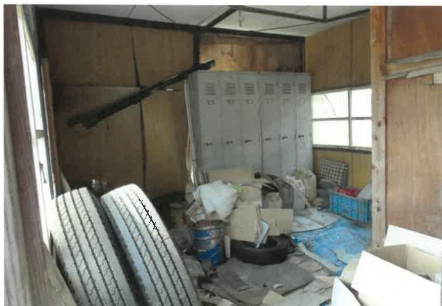
物件4未登記附属建物:1階西側物置の状況
