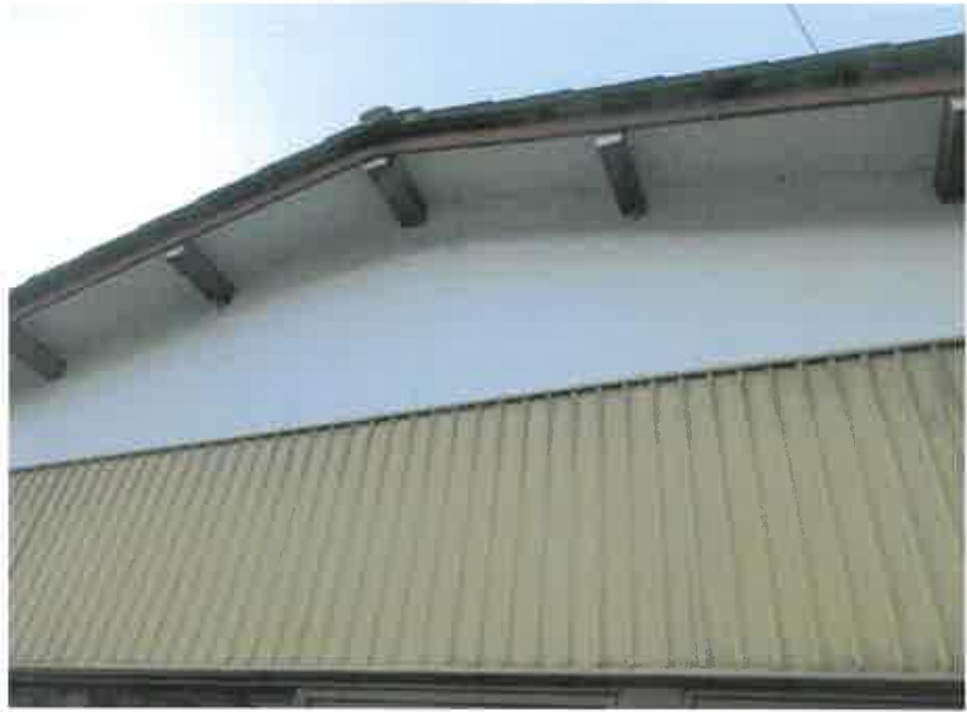
物件1:外壁の亀裂の状況
