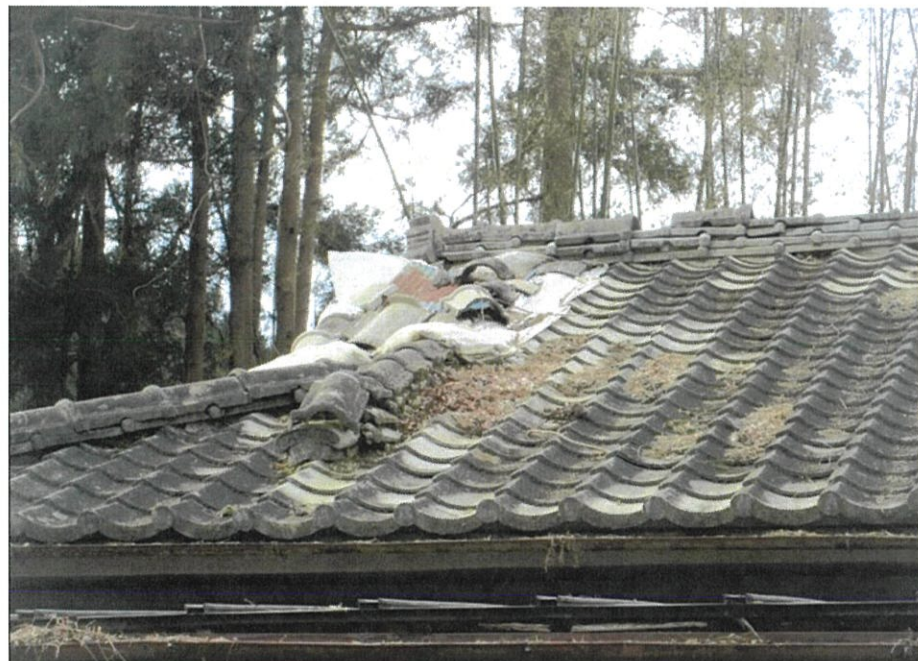
物件3:屋根瓦の破損した状況
