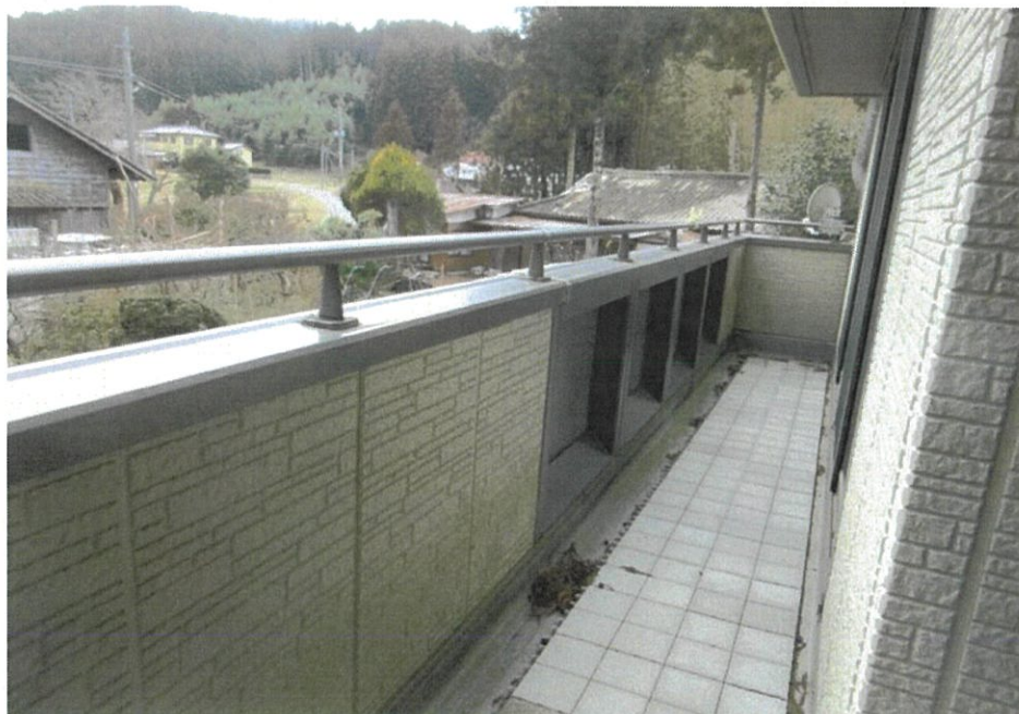
物件2:主である建物2階ベランダの状況 No. 10
