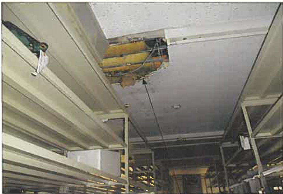
雨漏りによる損傷
