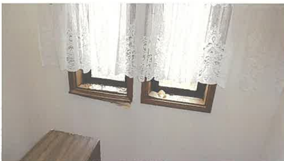
階段踊り場の窓枠等（結露）の状況
