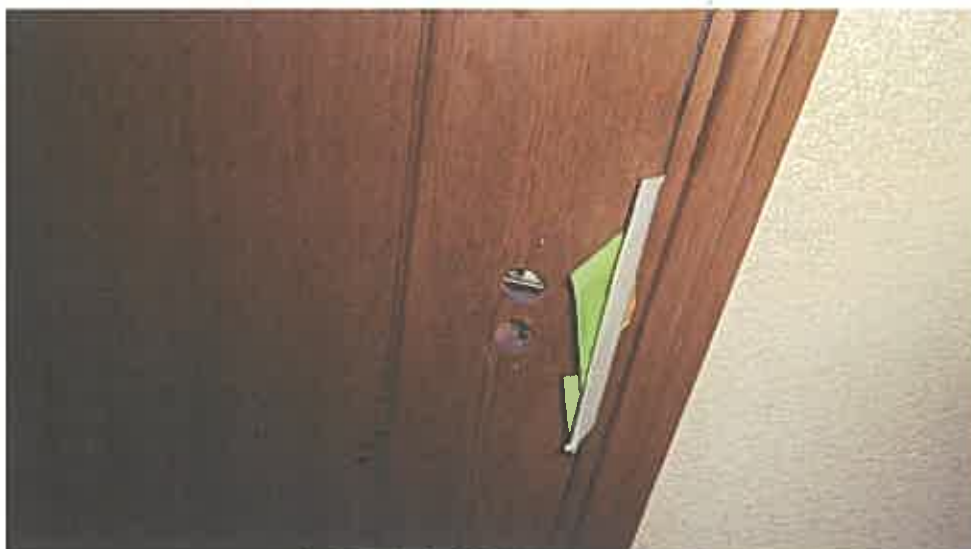
前同（トイレのドアノブの破損）
