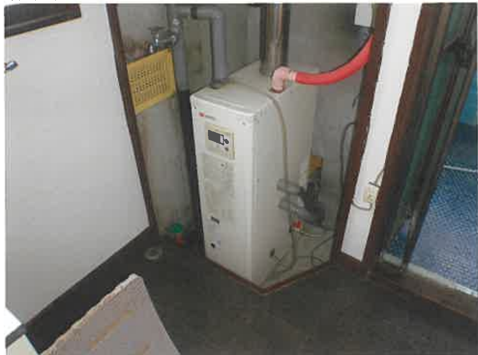
物件 6 洗面脱衣室とボイラー
