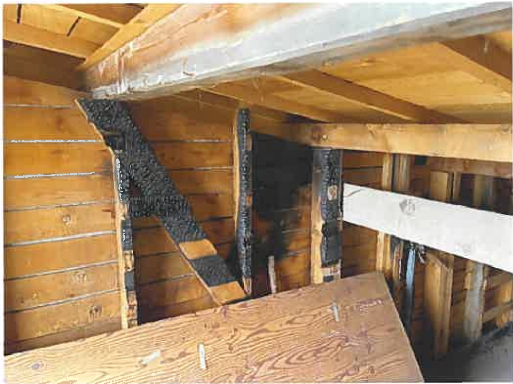
物件 2 2階の火災の影響が残る屋根裏部分
