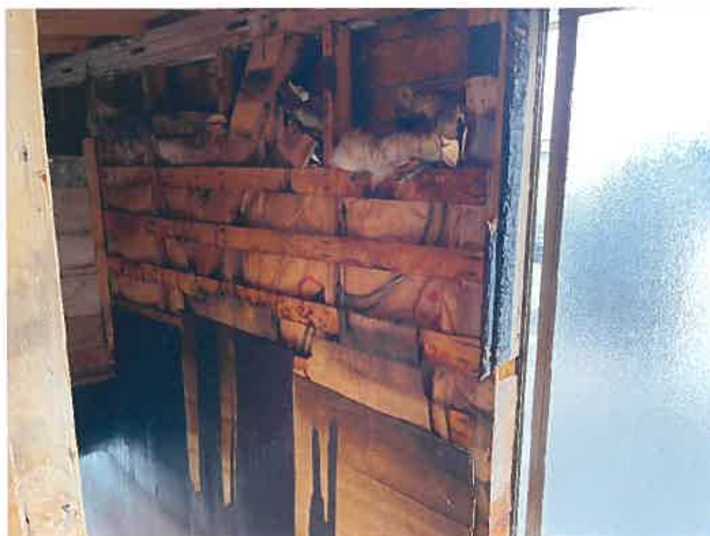
物件 2 2階の火災の影響が残る壁面
