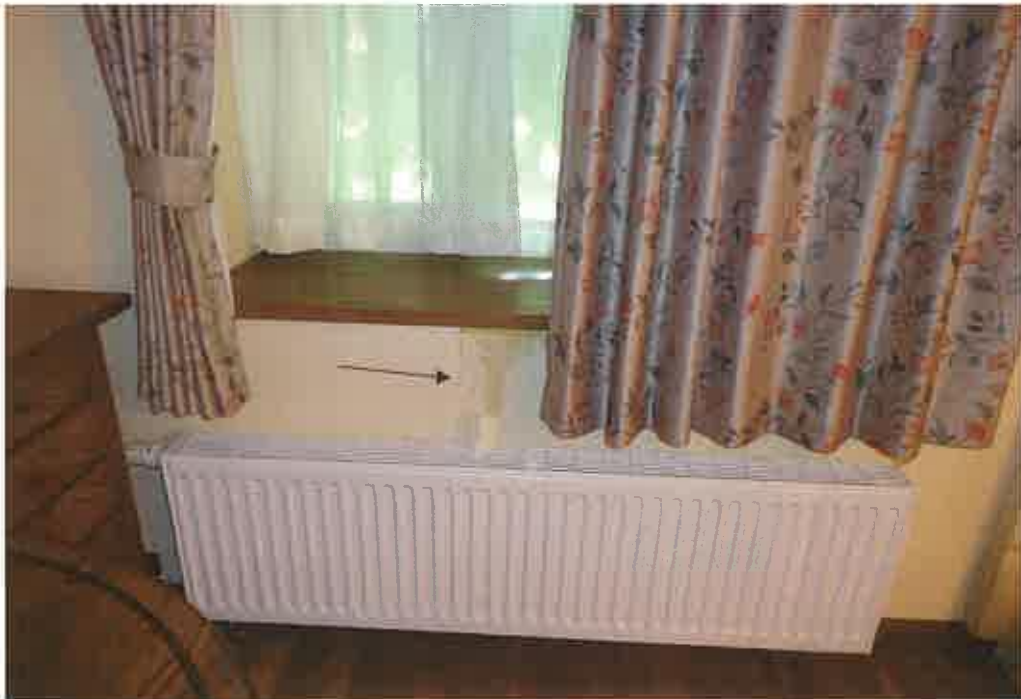
1 階 北東側居間・食堂 壁紙の剥がれ
