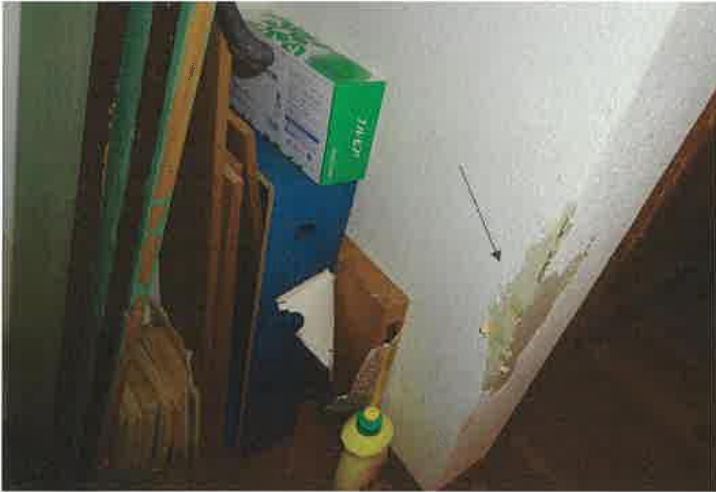
1階 北東側居間・食堂 ひっかき傷
