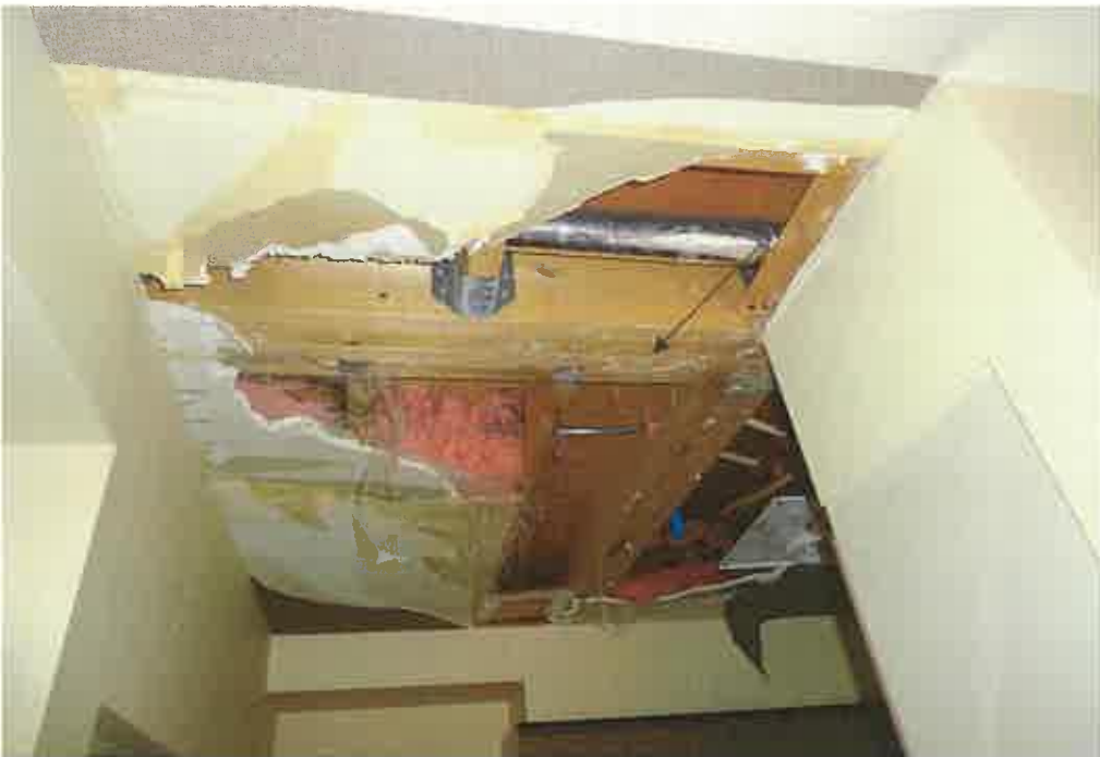
1階 台所 天井の破損
