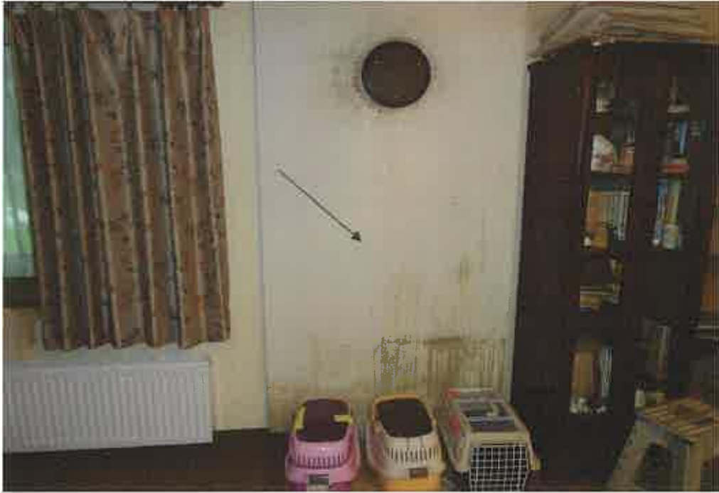
1 階 北東側居間・食堂 内壁の汚損
