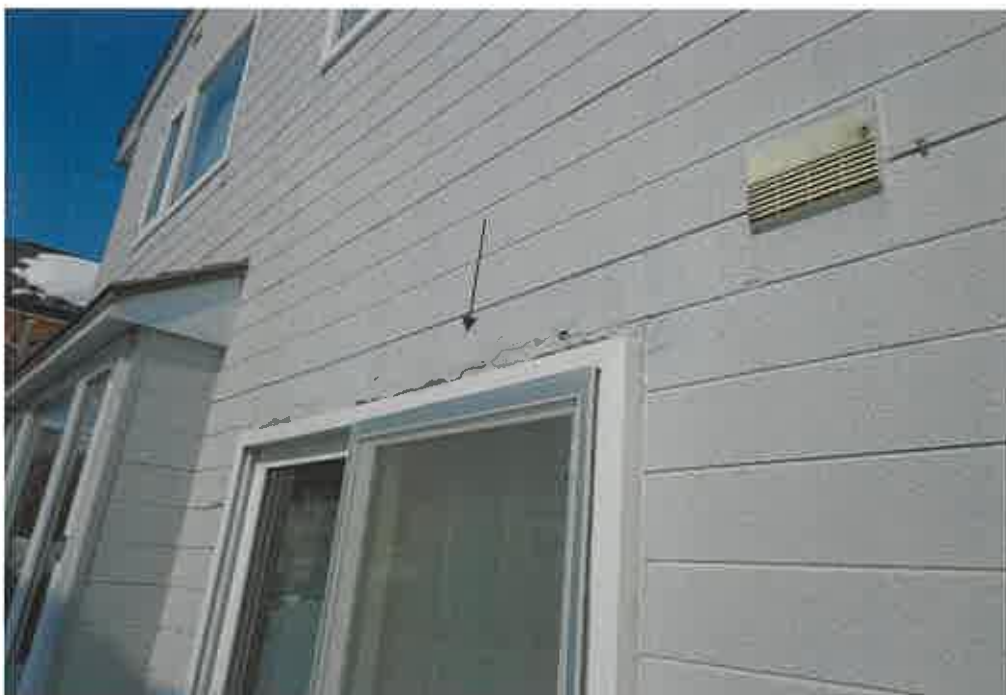
外壁の損傷（和室1 窓上部付近）
