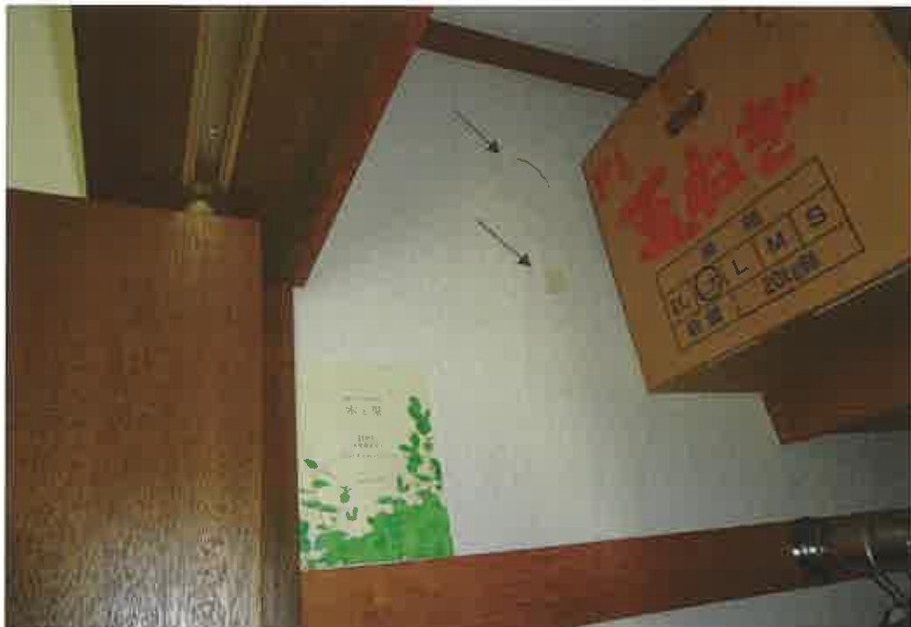
和室2 クローゼット内の亀裂及び壁紙の剥がれ
