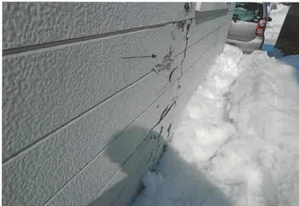
外壁の損傷（洋室1 窓付近）
