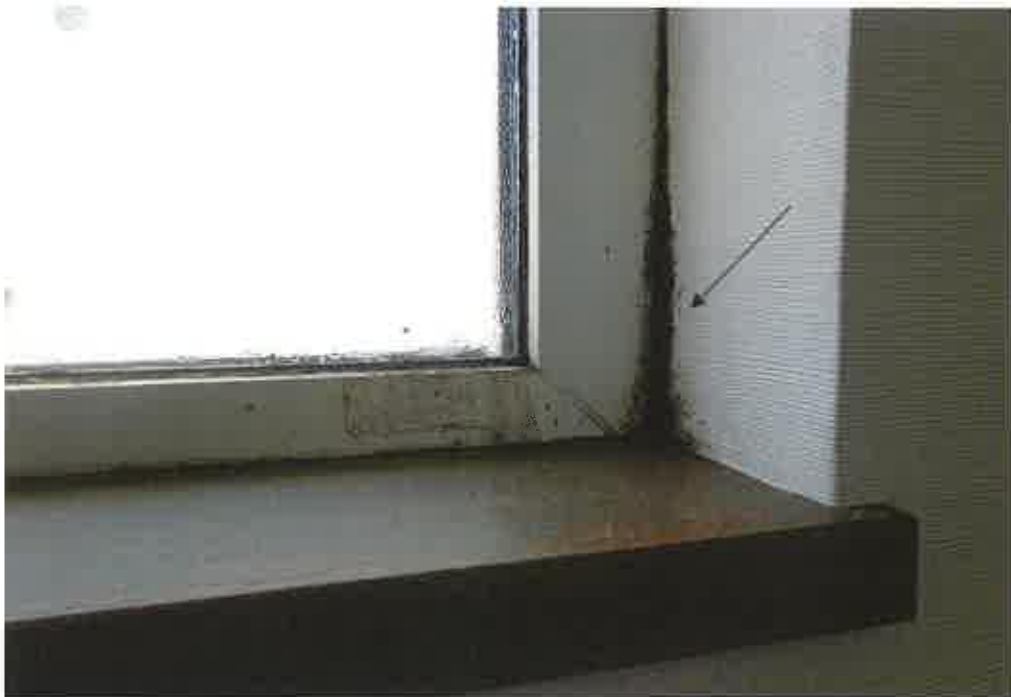
階段 窓付近の黒カビの汚損
