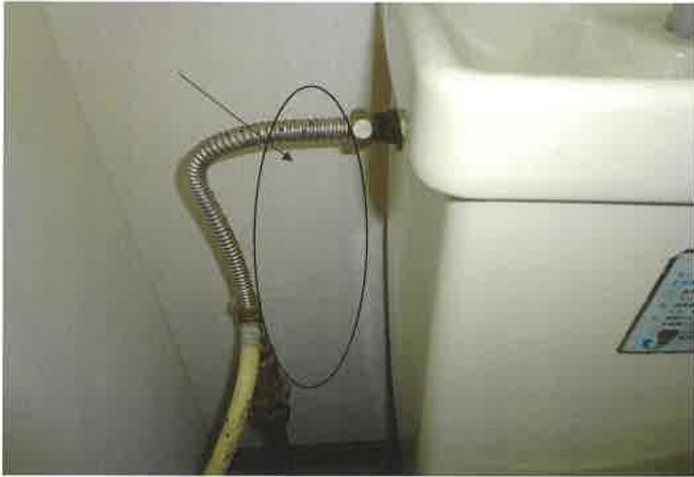
トイレ 内壁の汚損
