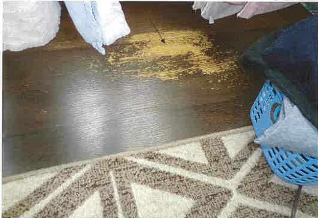
居間 出窓付近の床の損耗
