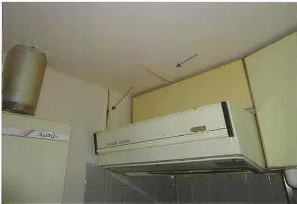
流し台付近の壁紙の剥がれ
