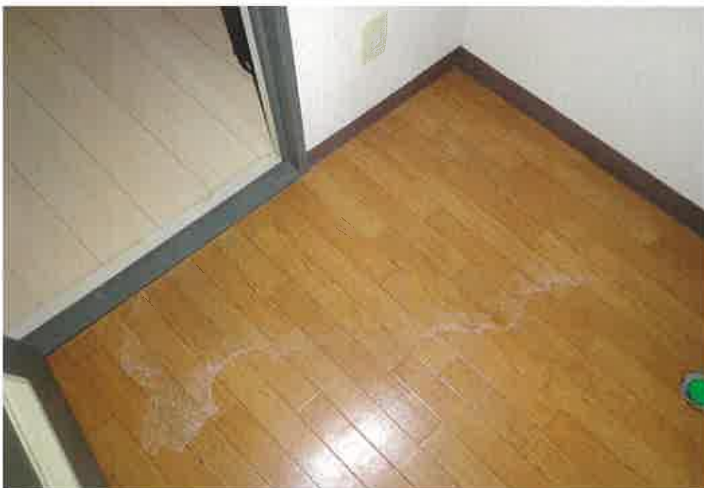
洗濯機置き場の水漏れの状況
