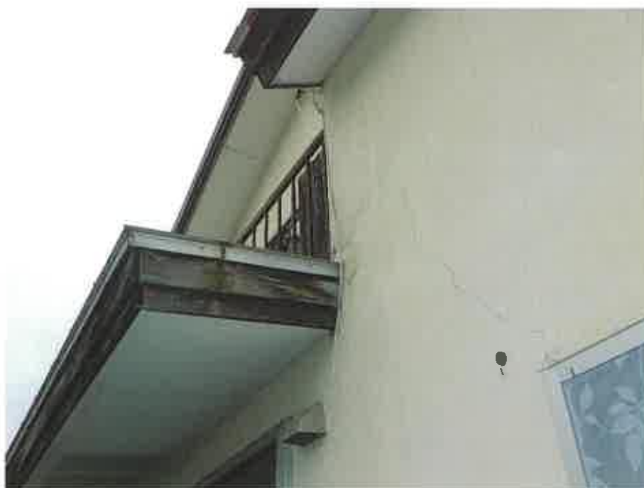
外壁等のひび割れ
