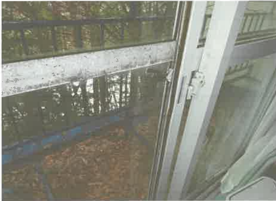
2階バルコニー（床板が存在しない）
