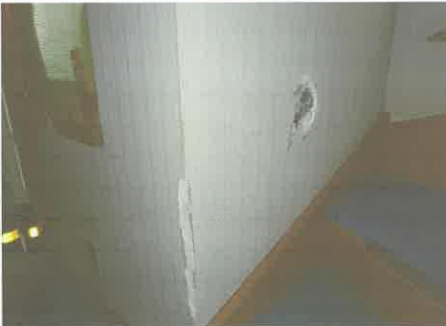
1階階段部分の損傷状況
