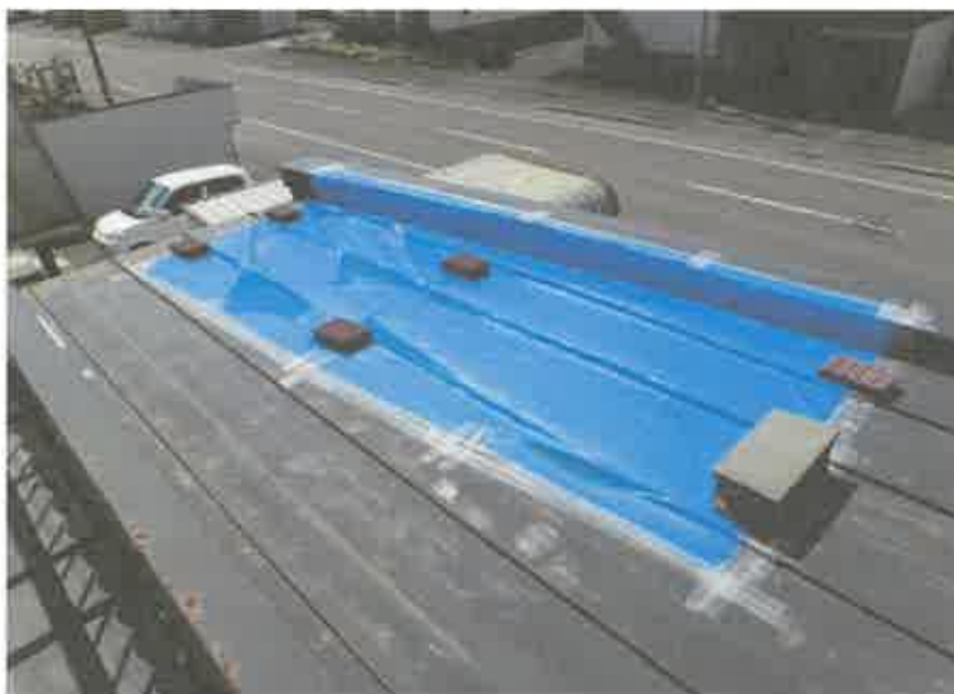
2階バルコニー先の屋根（1階居間の上）の雨漏り部分
