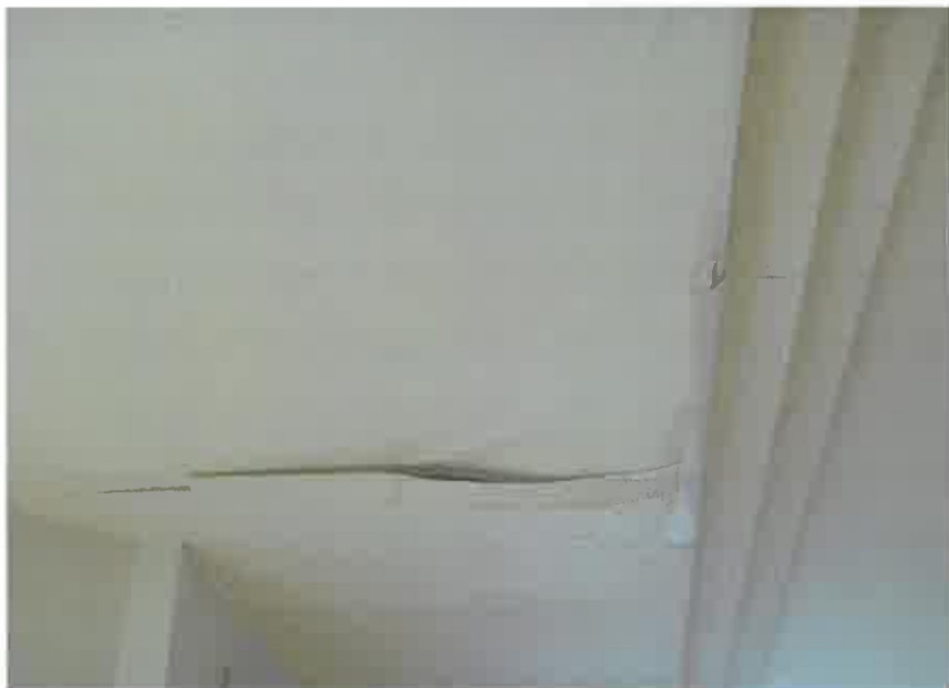
1 階居間の天井クロスの剥離
