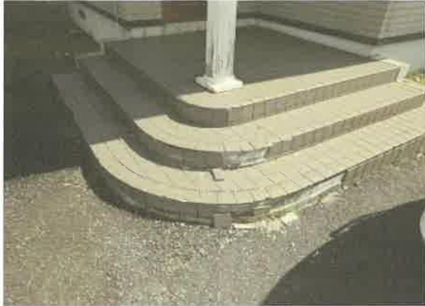
玄関ポーチの損傷
