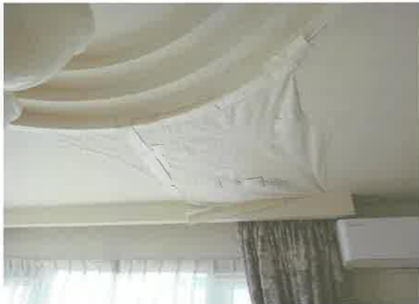
1 階居間の天井の雨漏り跡
