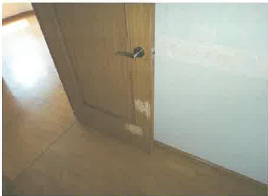
1 階洋室 1 のドアの損傷
