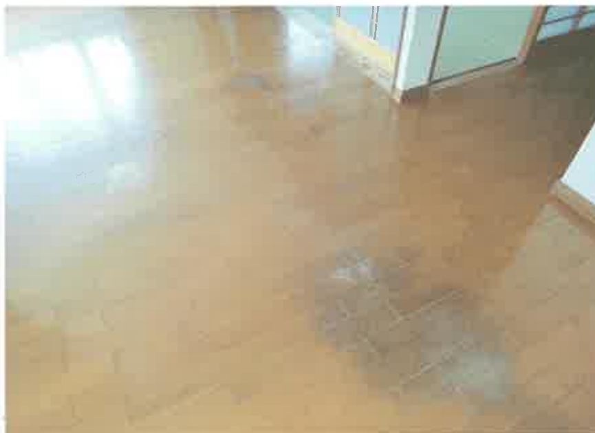
1階居間の床の染み
