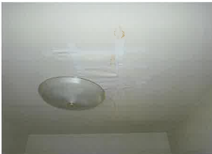
1 階洋室 1 の天井の水漏れ跡
