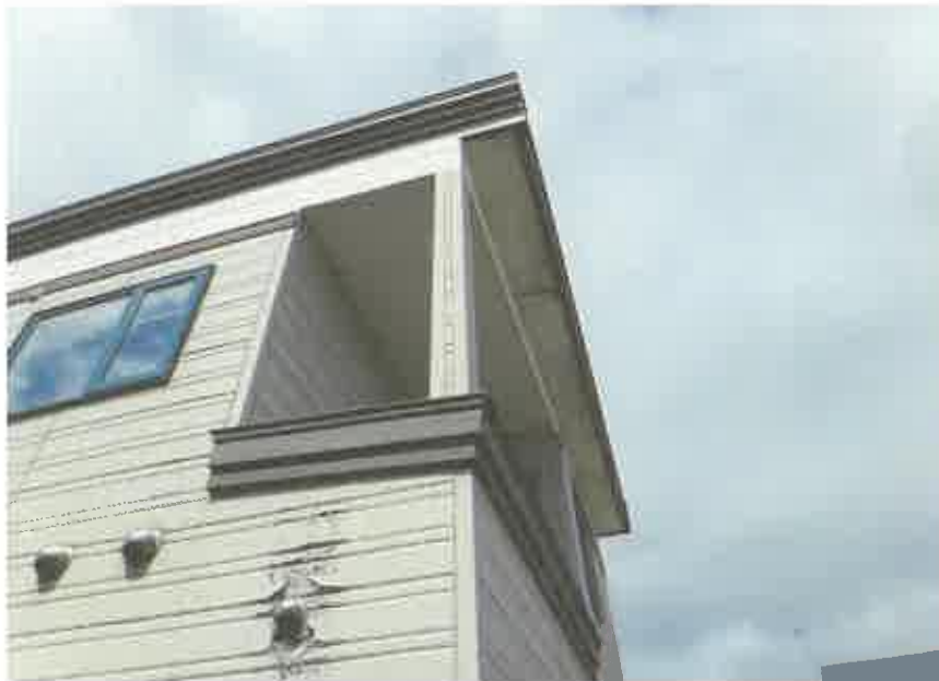
本件建物の軒裏ボードの損傷状況
