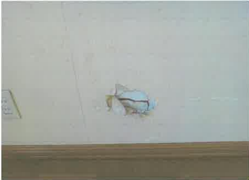
2階洋室3の略南西側窓下の凹み穴
