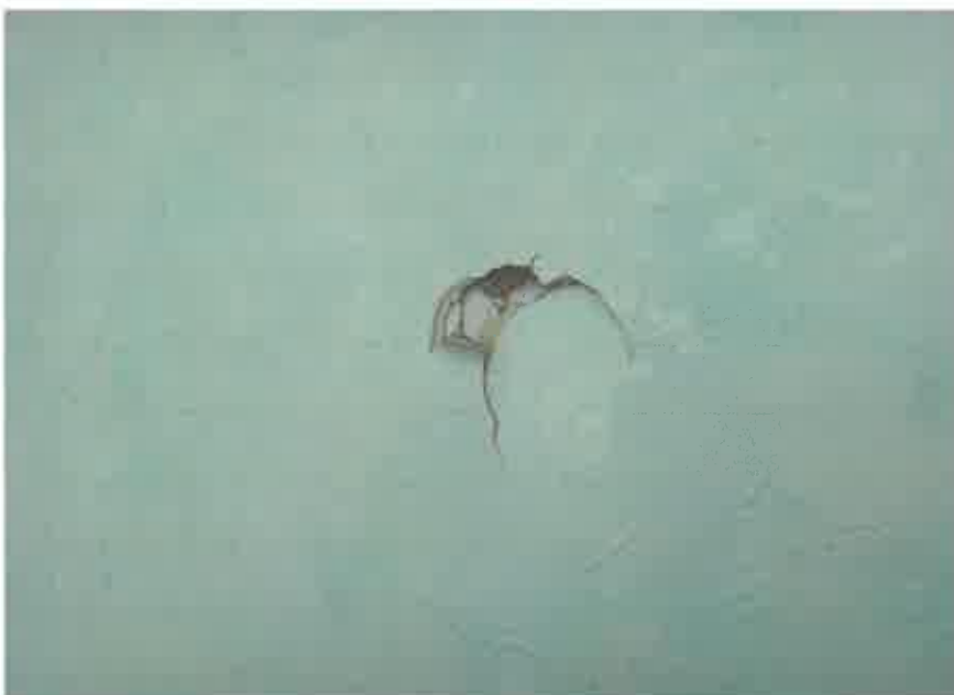
階段付近の壁の凹み穴
