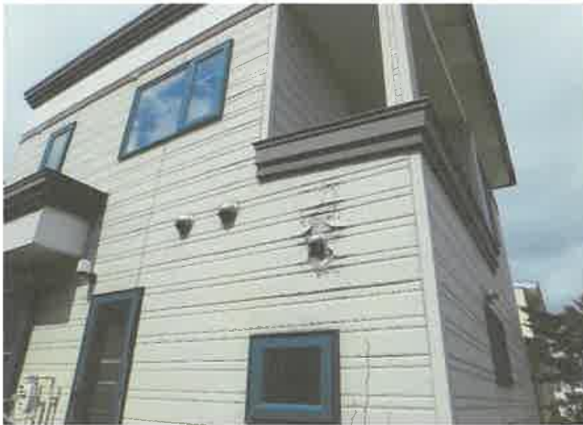
本件建物の外壁の損傷状況
