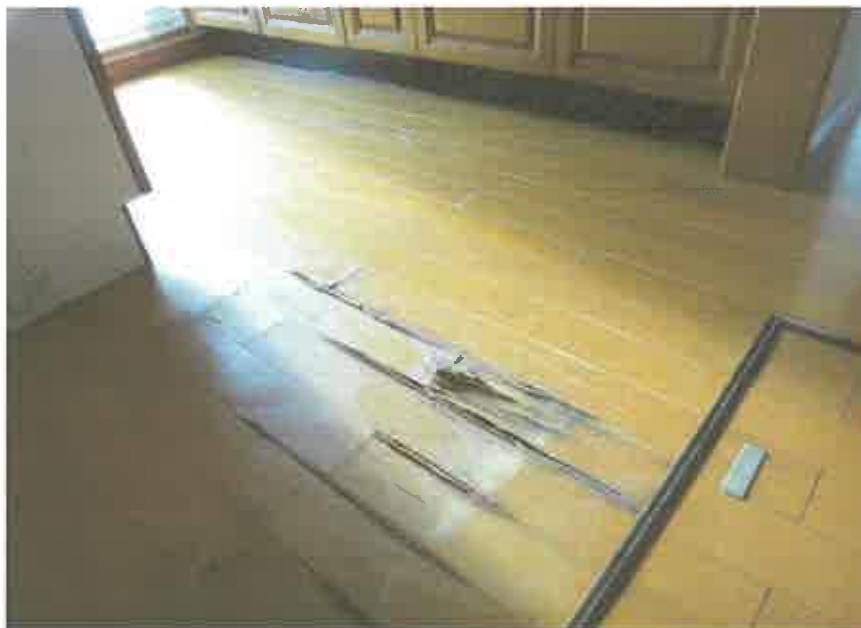
1 階台所の床の損傷
