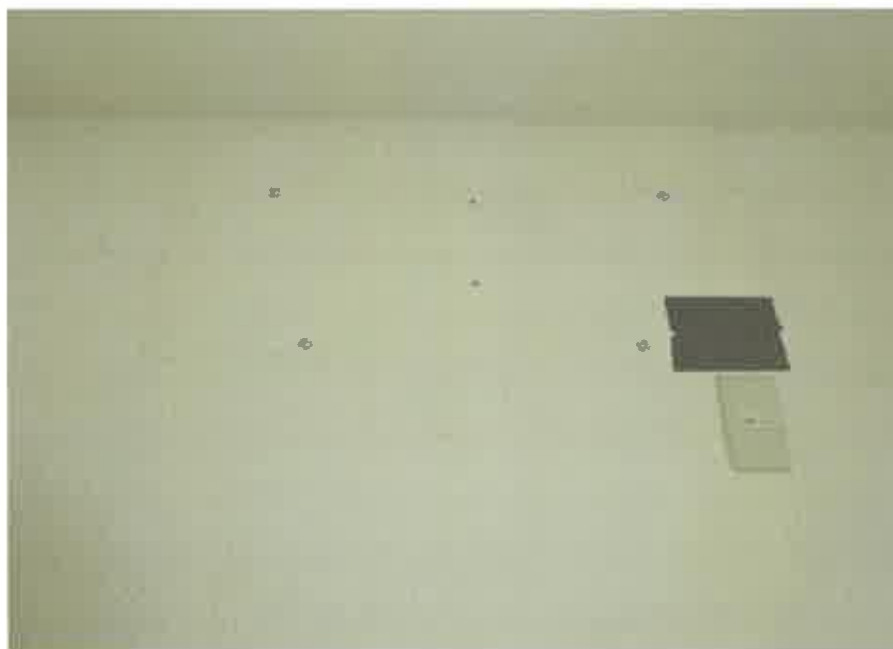
1 階居間のエアコンを取り外した跡
