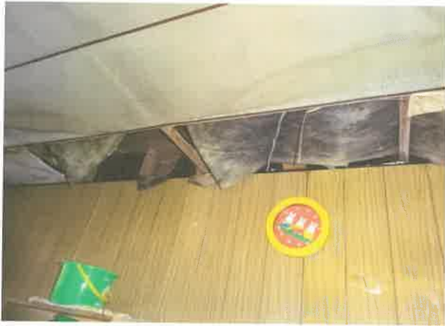
2階洋室2の天井の崩落状況
