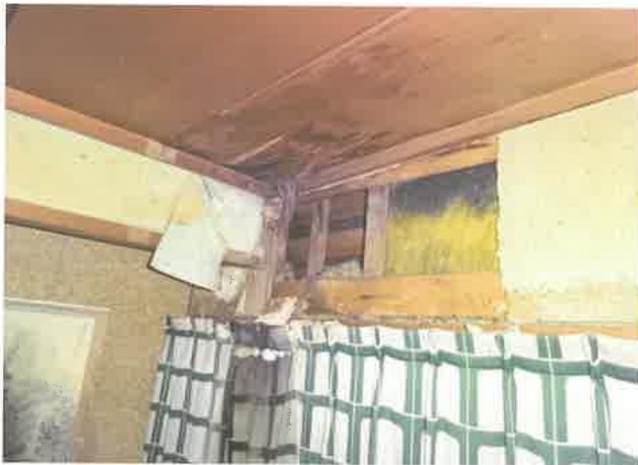
2 階和室窓側の壁付近の損傷状況
