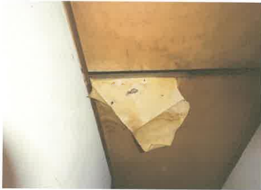
2 階廊下の天井クロスの剥離状況
