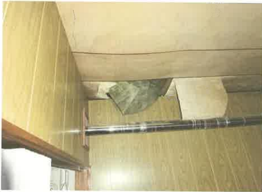
2階洋室3の天井の崩落状況
