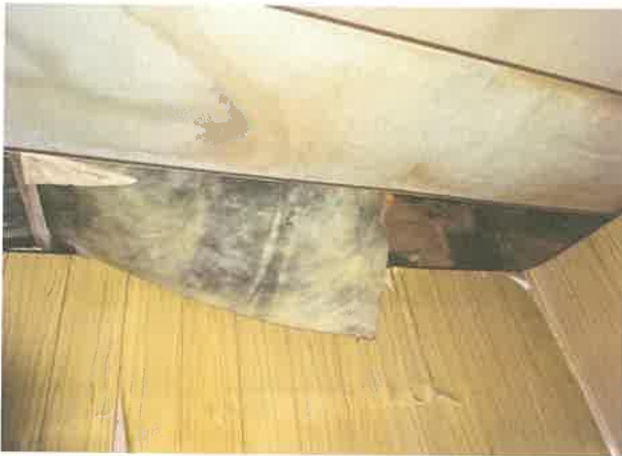
2階洋室2の天井の崩落状況
