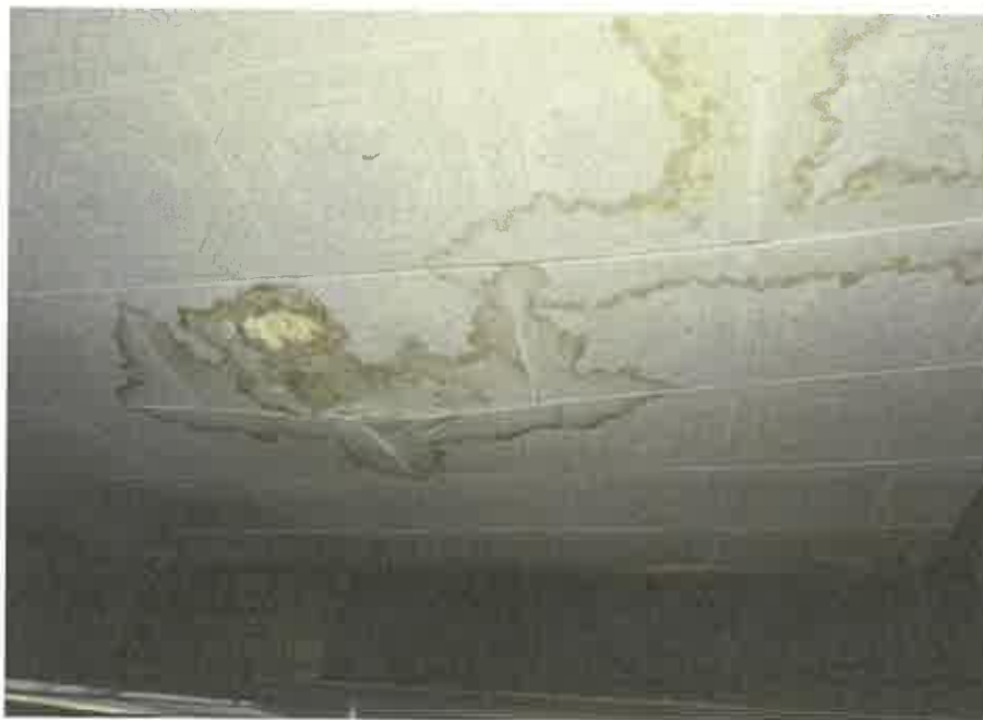
2階居間の天井クロスのふくらみ及び染みの状況
