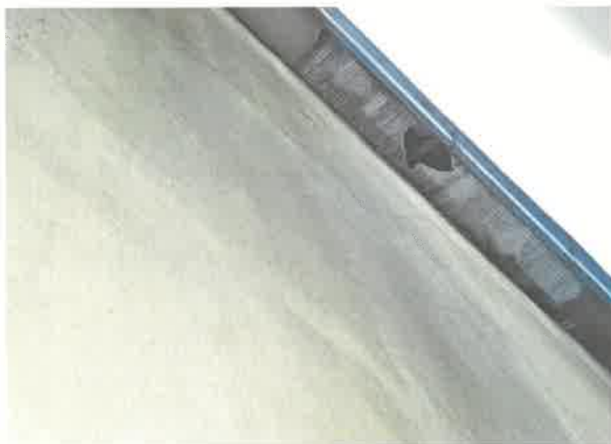
軒天の損傷状況
