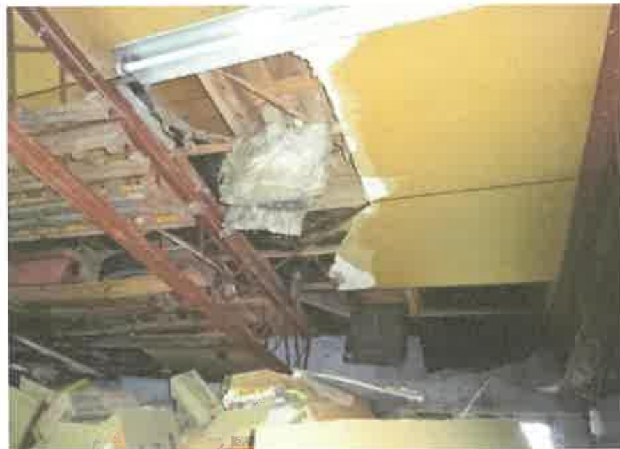
1 階倉庫の天井の損傷状況
