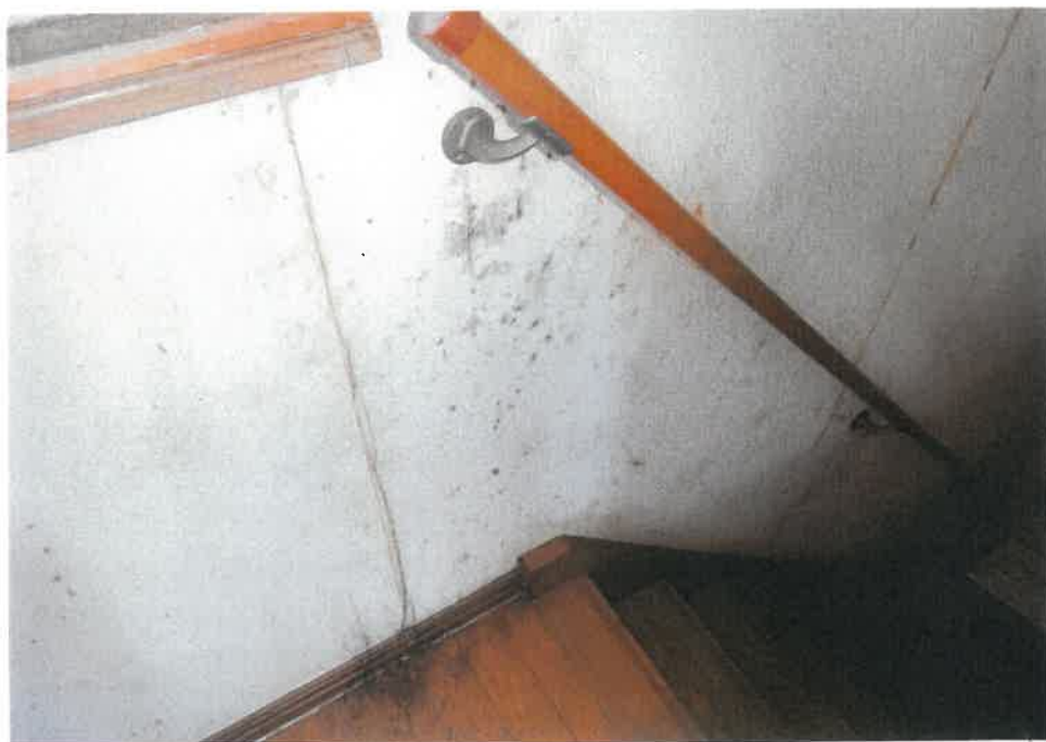
⑪ 階段の壁の汚損
