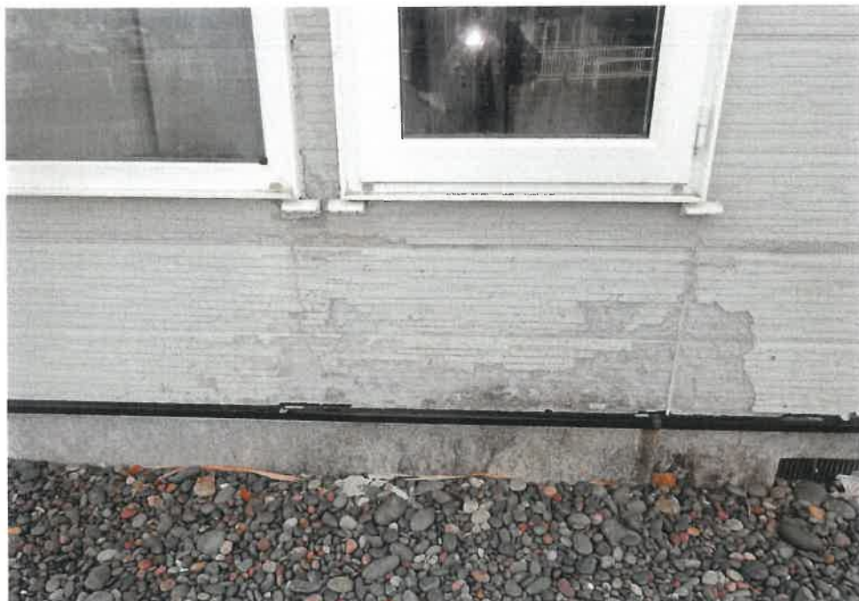
②⑩ 外壁の損傷
