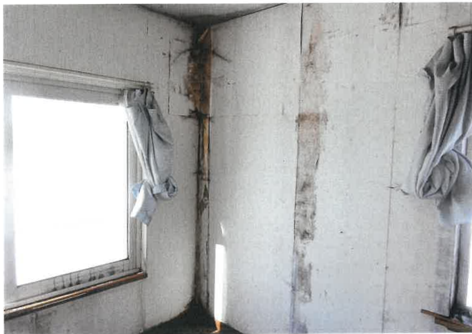
⑪ 2階 洋室1の壁の汚損、クロス剥離
