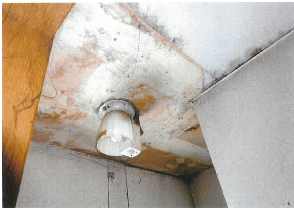
⑮ 2階 トイレの天井の汚損
