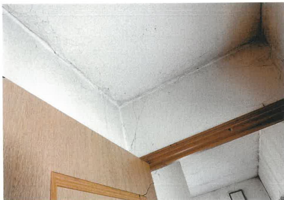
⑯ 2階 ホールの天井の汚損
