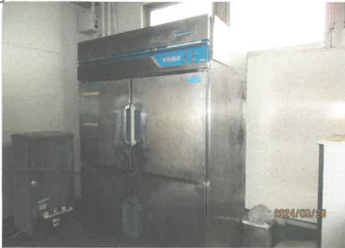
物件3 2階 冷蔵（凍）庫
