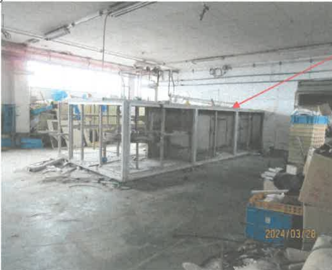
物件3 3階 コンベア式乾燥設備
