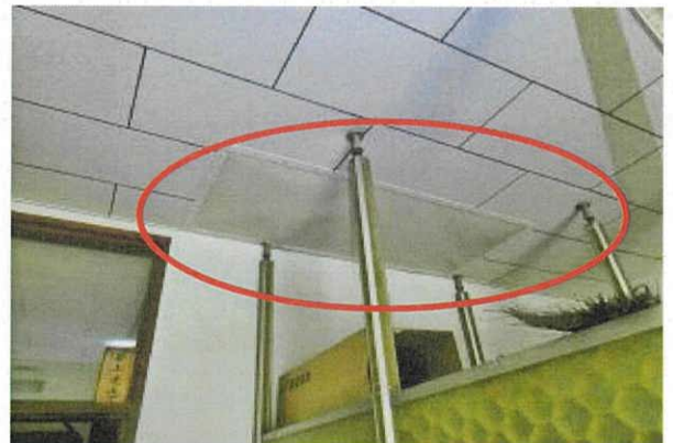
雨漏り補修痕の状況
