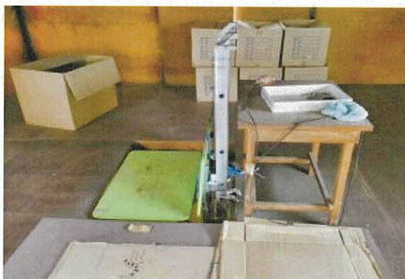
荷物用小型軽量昇降機の状況
