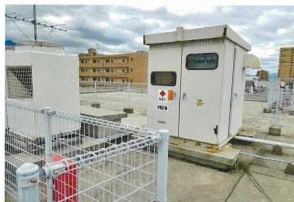
屋上のキュービクルの設置状況
