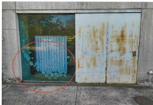
ヒビ割れの状況
