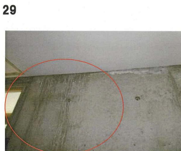
雨漏り跡の状況
