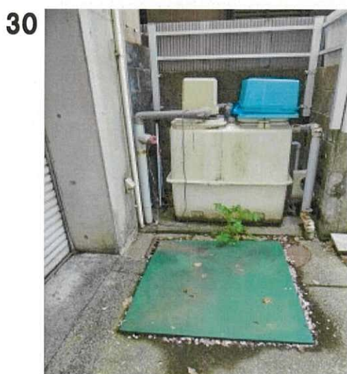
受水槽の状況
