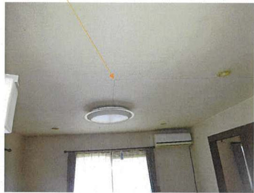
⑭ 天井クラック
