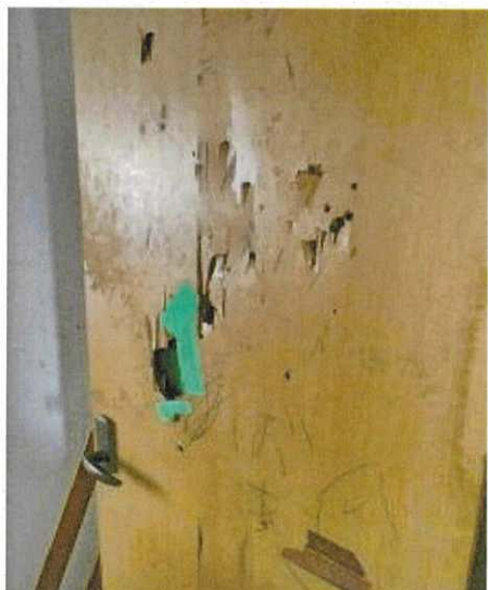
ドアの損傷状況
