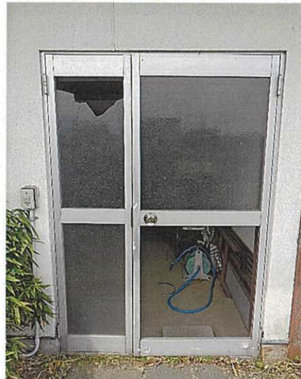
50 (ドアのガラスの破損状況)
