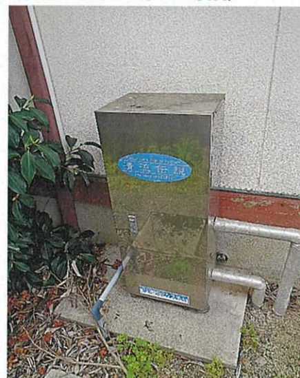
10 (浄化・活水システムの状況)
