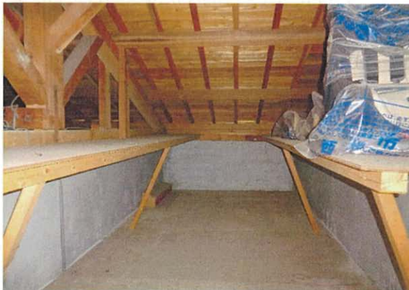
49 (小屋裏収納の状況)
