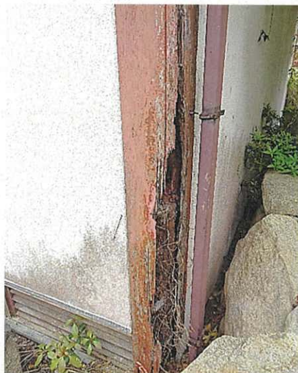
51 (柱の腐食状況)
