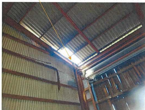
⑦ 屋根損傷部分
