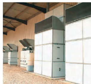
Ventilation répondant aux normes sanitaires et environnementales
