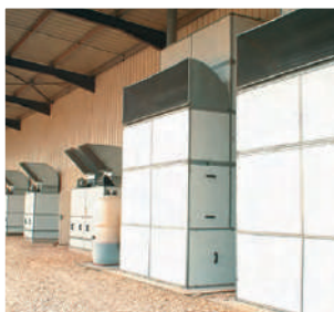
Ventilation répondant aux normes sanitaires et environnementales
