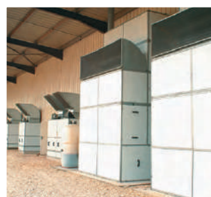
Ventilation répondant aux normes sanitaires et environnementales
