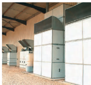
Ventilation répondant aux normes sanitaires et environnementales
