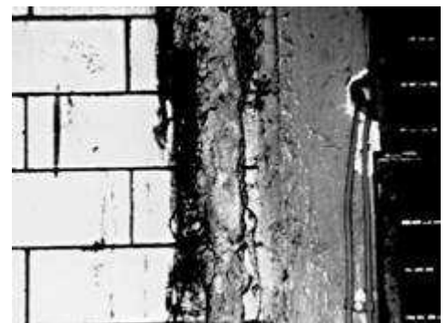
Asbestos lagged pipe
