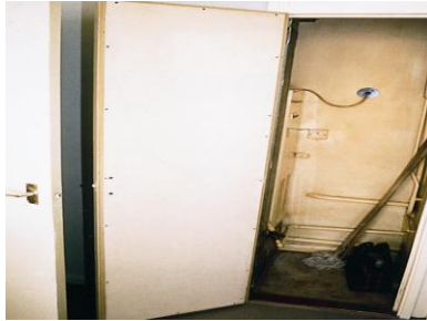
Asbestos door lining
