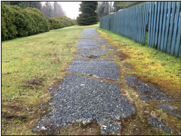
27. Uneven (trip hazard)
