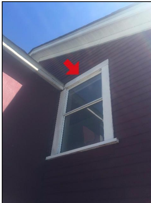
25. Missing Drip Edge
