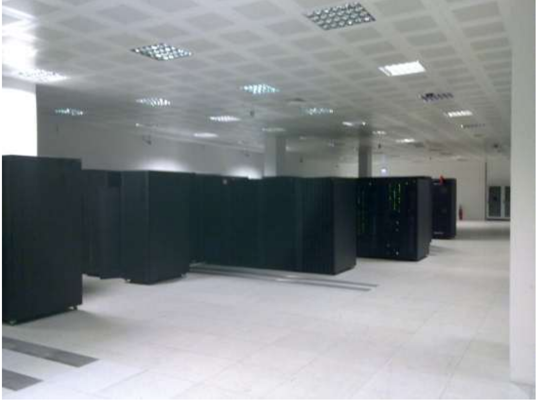
Şekil 9: Adalet Bakanlığı UYAP Sistem Odası
