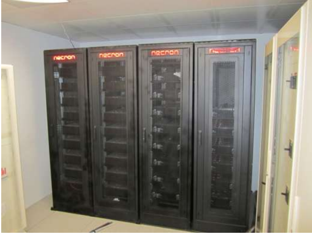
Şekil 7: Sistem Odası Enerji Ünitesi
