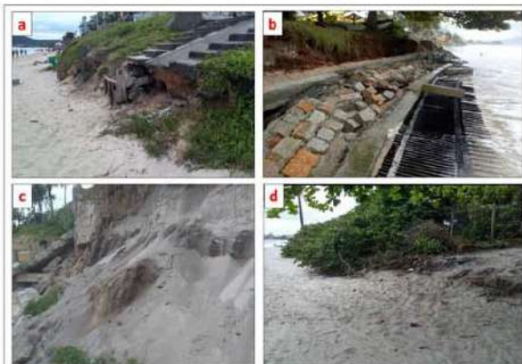
Figura 2: Pontos onde foram reconhecidos indicadores de erosão costeira: (a) e (b) Construção e destruição de estruturas artificiais; (c) erosão progressiva de depósitos marinhos e/ou eólicos (PEREIRA, 2018); e (d) Destruição de faixas frontais de vegetação.
