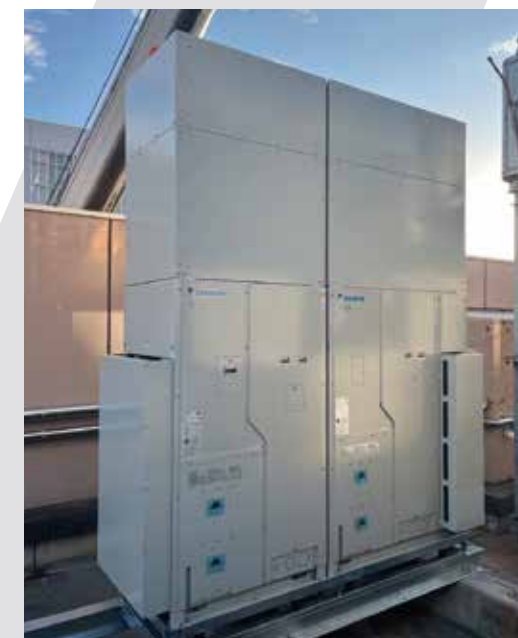
ビルマル用防音ダクトも同時に納入。
